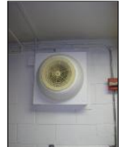
Kitchen exhaust fan
