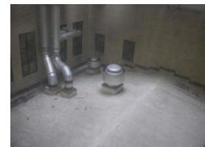
Kitchen exhaust fan
