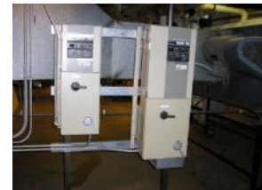
AHU supply fan section
