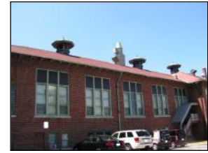
2003 Roof lab exhaust fan
