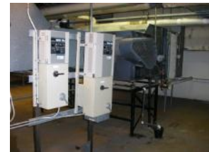
AHU supply fan section
