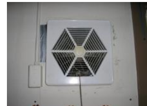
Wall propeller exhaust fan (kiln room)
