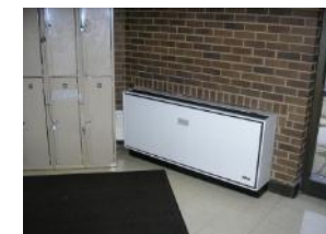
Fan coil unit
