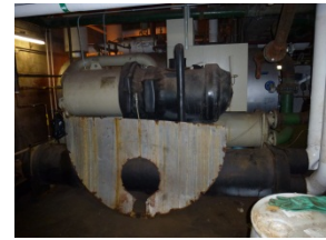
Water chiller (subbasement)
