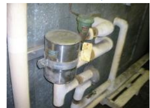
AHU humidifier section
