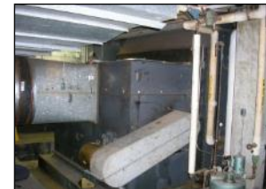
Air handling unit supply fan section
