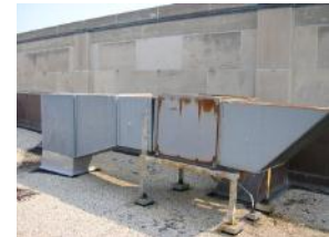
Inline toilet exhaust fan
