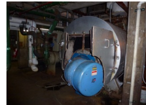
Hot water boiler (subbasement)
