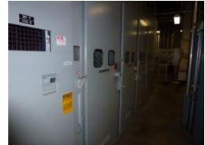
S&C 13.2kV Switchgear
