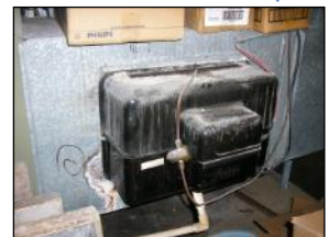
Inline humidifier (AHU-1)
