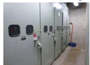
S&C 13.2kV Switchgear
