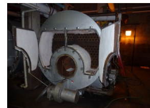
Hot water boiler (subbasement)
