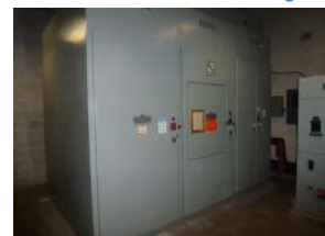
S&C 13.2kV Switchgear
