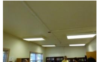
Fire Alarm Conduit
