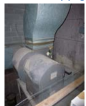
Existing exhaust fan
