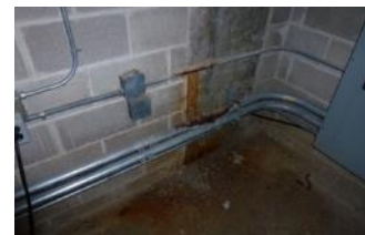
Corrosion on existing conduits
