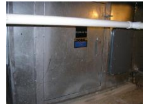
Return air fan
