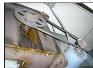
AHU supply fan section
