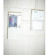
DDC thermostat & CO2 sensor
